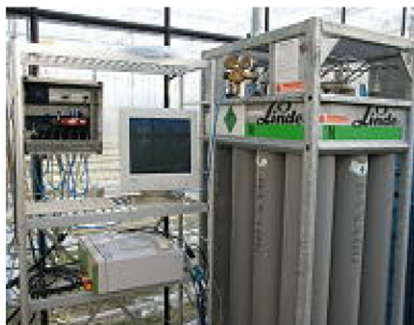
Foto 2: Regel- und Verteilstation mit Datenerfassung sowie ein 12 x 50 l BANARG ® -Bündel der Fa. Linde Gas
