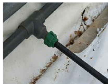
Foto 5: Einfach und praktisch: Verteilung des Ethylens über die vorhandenen CO 2 -Verteilschläuche
