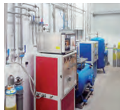
Bild oben: Magerluftregelanlage Bild unten: Zentrale Gasmischstation Lebensmittelproduktion
